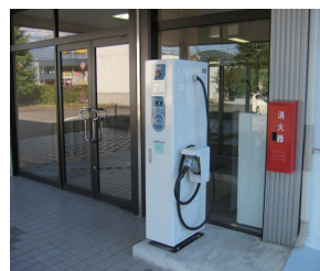
工場にニチコン製急速充電器を設置し 広く市民に開放
