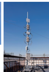
市庁舎に設置されたアンテナ
