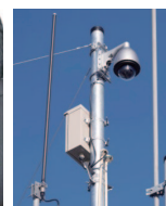
市庁舎屋上に設置された監視カメラ
