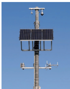
沿岸津波監視システム（正面写真）
