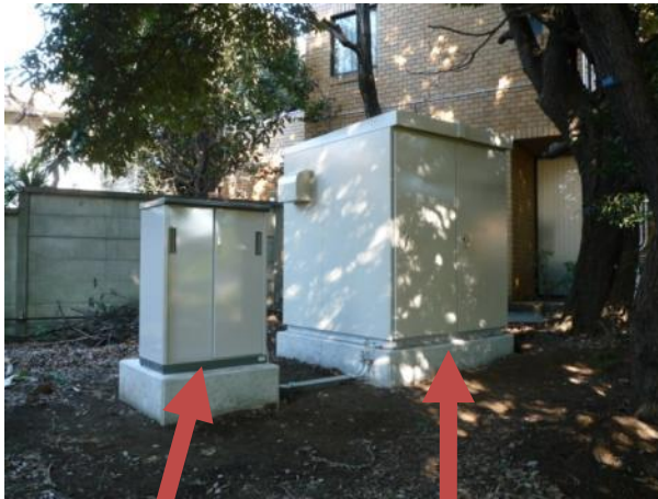
蓄電池 パワーコントローラと計測機器
