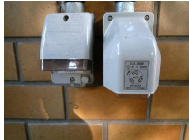
充電コンセント
