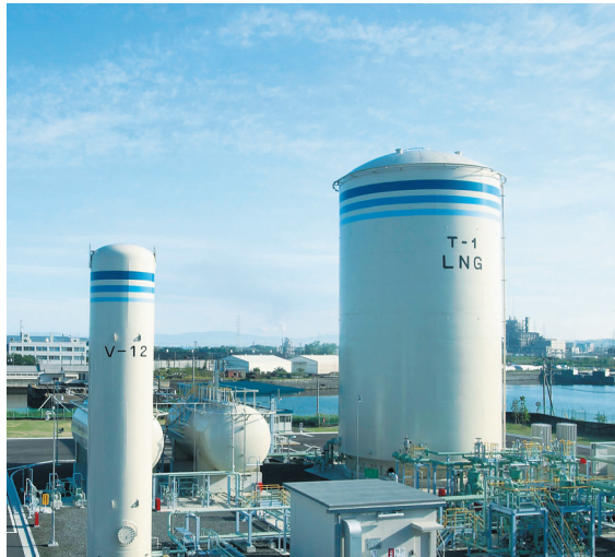
導入先：九州ガス圧送株式会社 大牟田工場
