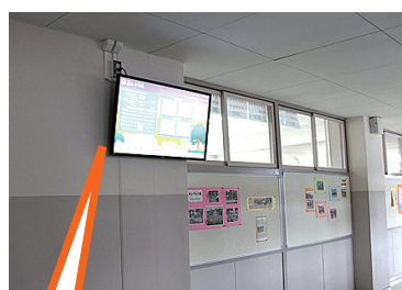
小学校に設置されたエネルギーの見える化モニタ。普段から児童に見てもらえるよう教室、職員室の近くに見えている。
